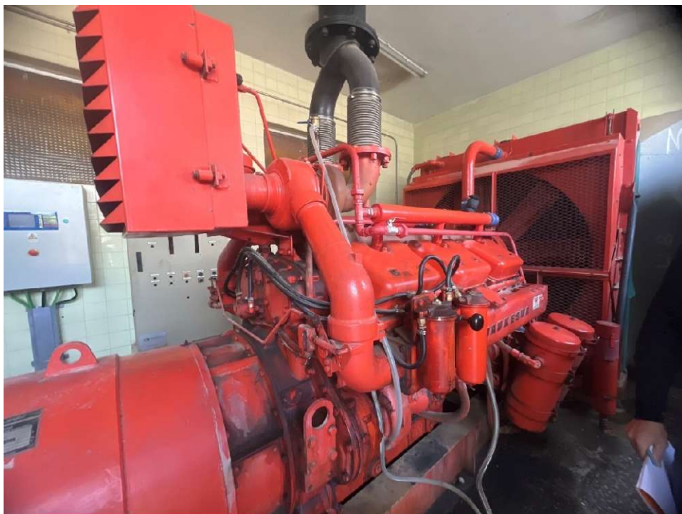
Ilustración 7. Grupo electrógeno 470 kVA existente.
