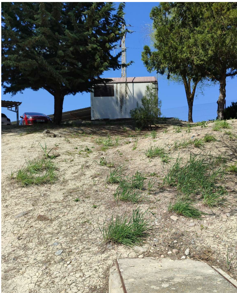
Ilustración 1. Centro de seccionamiento.
