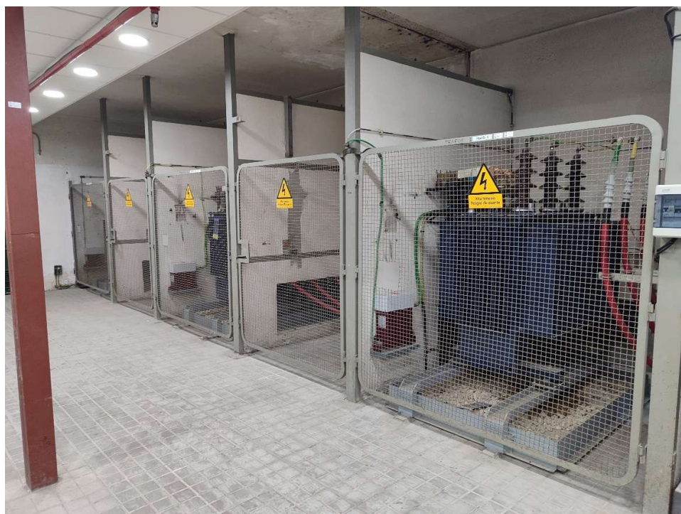
Ilustración 4. Transformadores de aceite.
