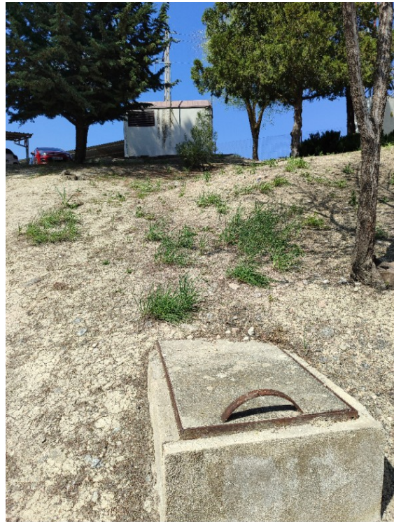
CENTRO DE SECCIONAMIENTO
