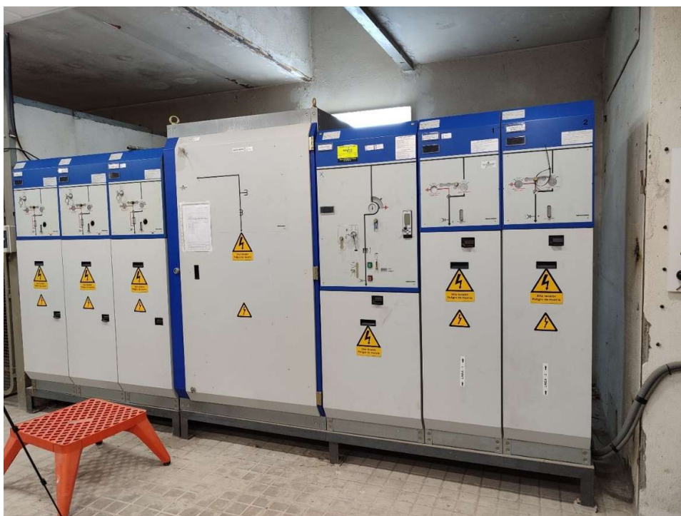
Ilustración 3. Celdas de protección y medida.
