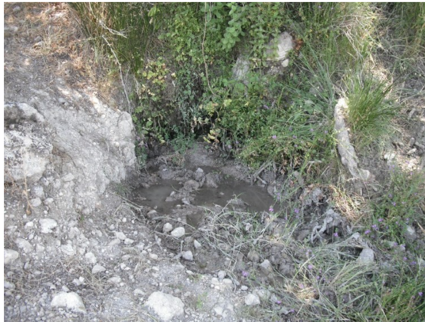
Figura 11.- Aspecto del afloramiento de agua en el p.k. 2+020 (40 mts MI)
