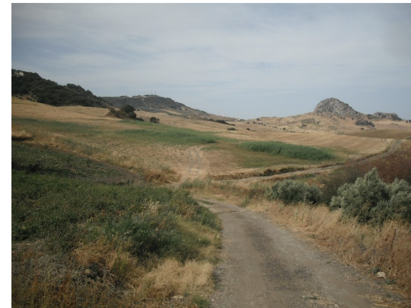
Figura 13.- Aspecto del camino afectado por el agua del p.k. 2+020 (40 mts MI)
