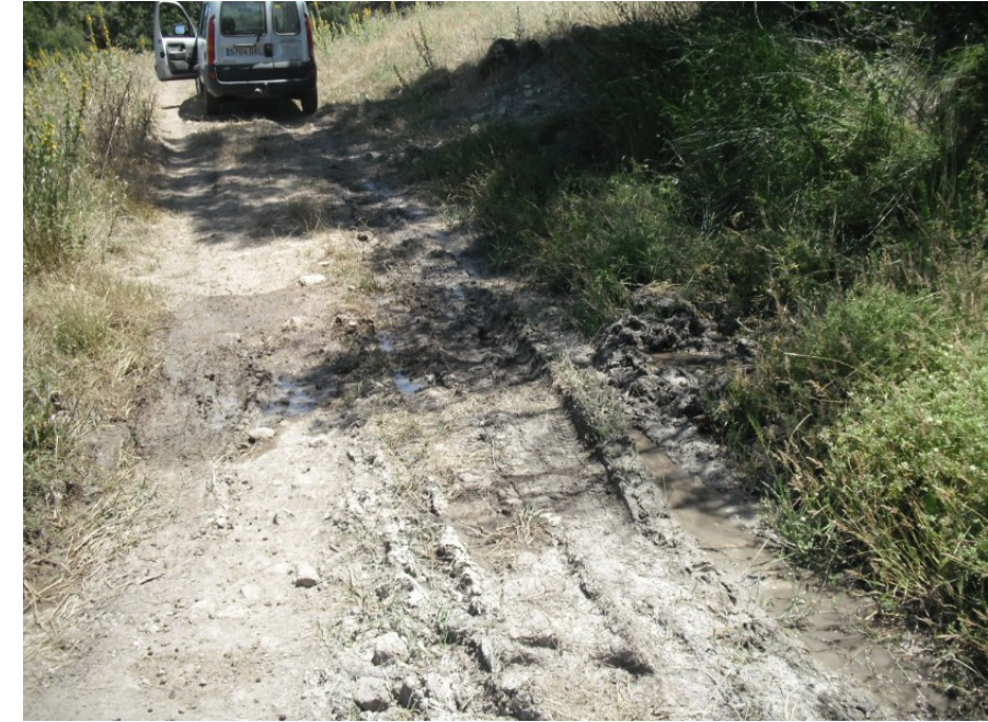
Figura 12.- Aspecto del camino afectado por el agua del p.k. 2+020 (40 mts MI)
