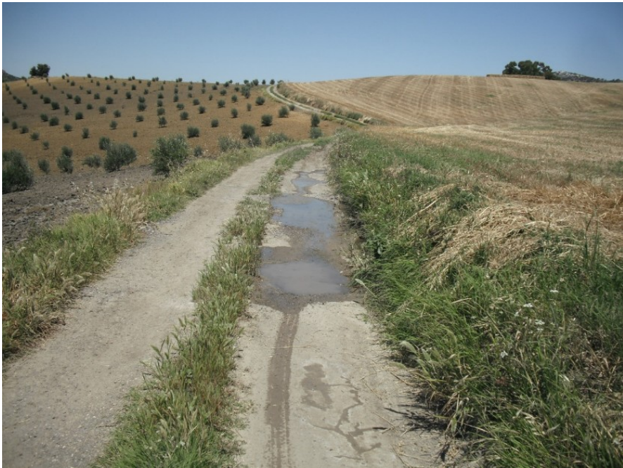
Figura 14.- Vista de acumulaciones de agua en el camino de acceso al Cortijo de Malacapa durante el verano
